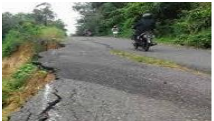
Gambar 4. 3 Tingkat kerusakan amblas (Sumber: Direktorat Jenderal Bina Marga, 1990)
