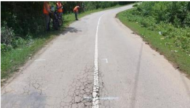
Gambar 4. 1 Tingkat kerusakan retak buaya (Sumber: Direktorat Jenderal Bina Marga, 1990)
