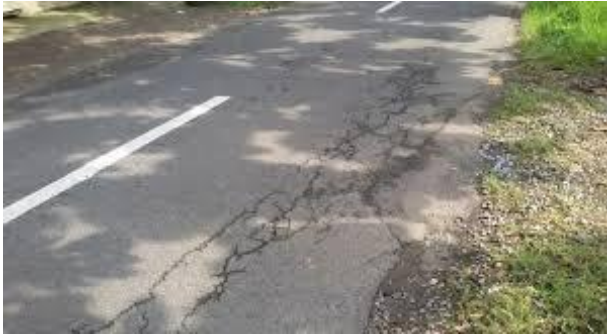
Gambar 4. 4 Tingkat kerusakan cacat tepi perkerasan (Sumber: Direktorat Jenderal Bina Marga, 1990).
