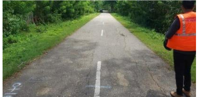
Gambar 4. 6 Tingkat kerusakan retak memanjang dan melintang (Sumber: Direktorat Jenderal Bina Marga, 1990).
