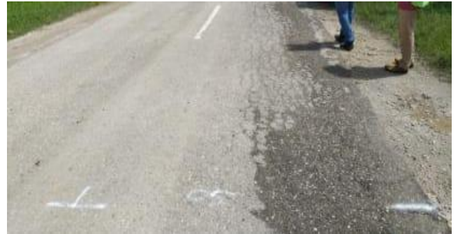
Gambar 4. 5 Tingkat kerusakan penurunan bahu pada jalan (Sumber: Direktorat Jenderal Bina Marga, 1990).
